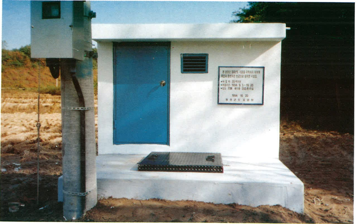
● 국민의 성금으로 설치된 지하 암반관정 기계실 전경
