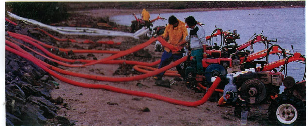
92년 봄부터 가을기 시작한 극심한 한해로 벼포기가 마르고 식수마저 고갈되는등 영호남 지방에 큰피해를 가져왔으며, 지하수개발 및 관정을 이용하여 한해 극복에 심혈을 기울였다.
